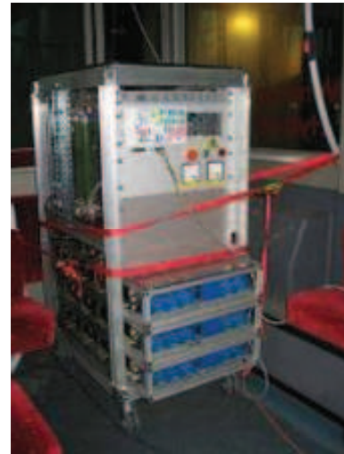
Figure 2-28. Armoire de supercondensateurs embarqués dans le microbus du LTE
